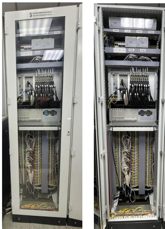
Рисунок 1 - Шкаф измерительного оборудования
