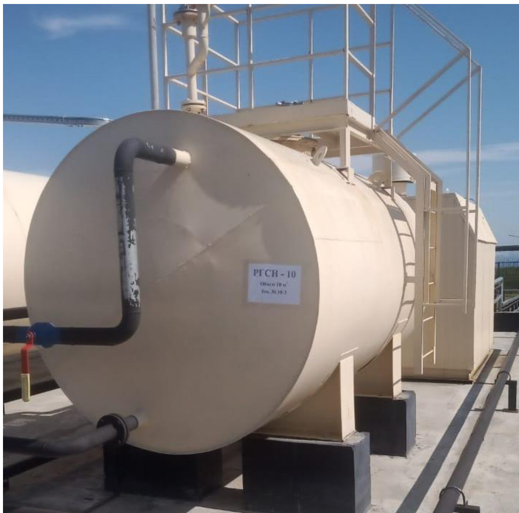
Рисунок 3 – Общий вид резервуара РГСН-10 зав.№ 10-3
