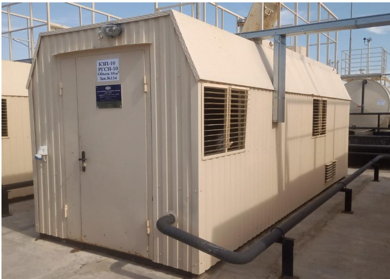
Рисунок 3 – Общий вид резервуара РГСН-10 зав.№ 134
