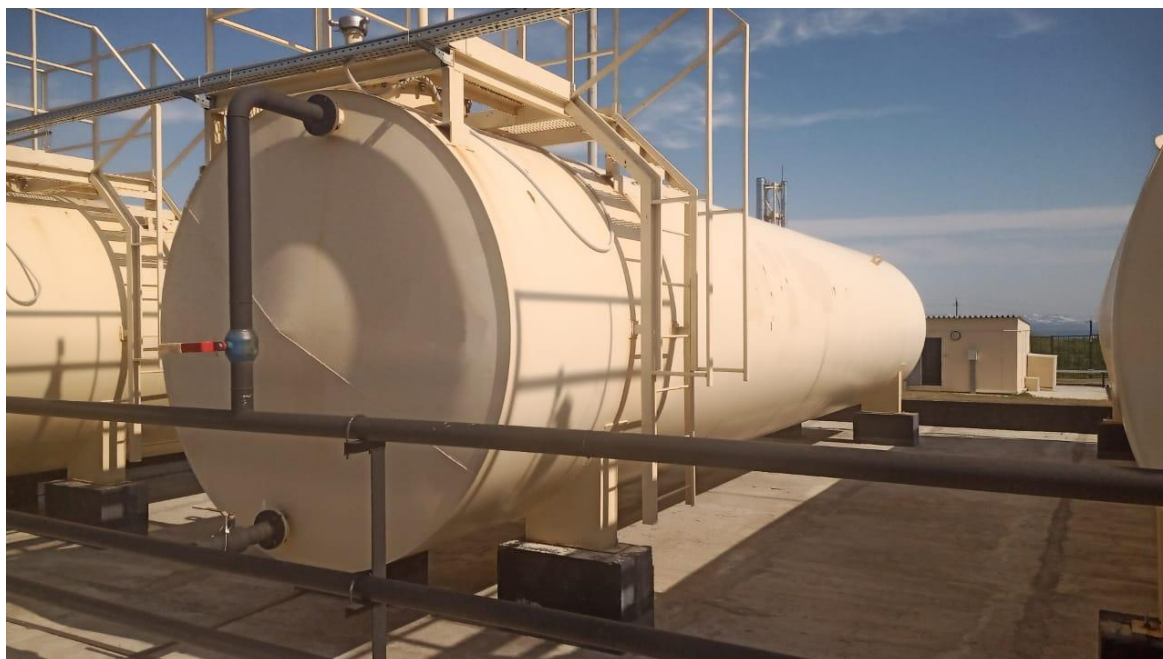
Рисунок 5 – Общий вид резервуара РГСН-50 зав.№ 84
