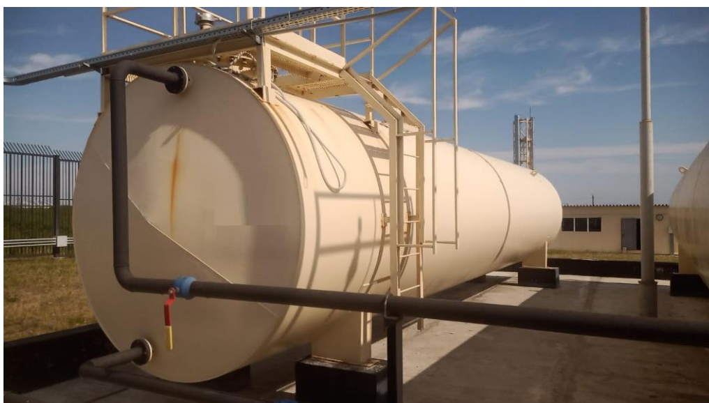
Рисунок 4 – Общий вид резервуара РГСН-50 зав.№ 78
