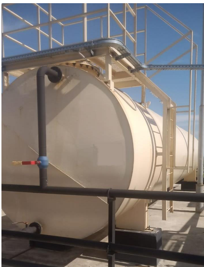
Рисунок 6 – Общий вид резервуара РГСН-50 зав.№ 105
