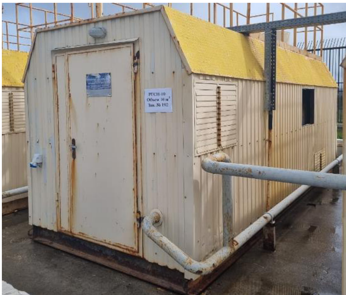
Рисунок 2 – Общий вид резервуара РГСН-10 зав.№ 192
