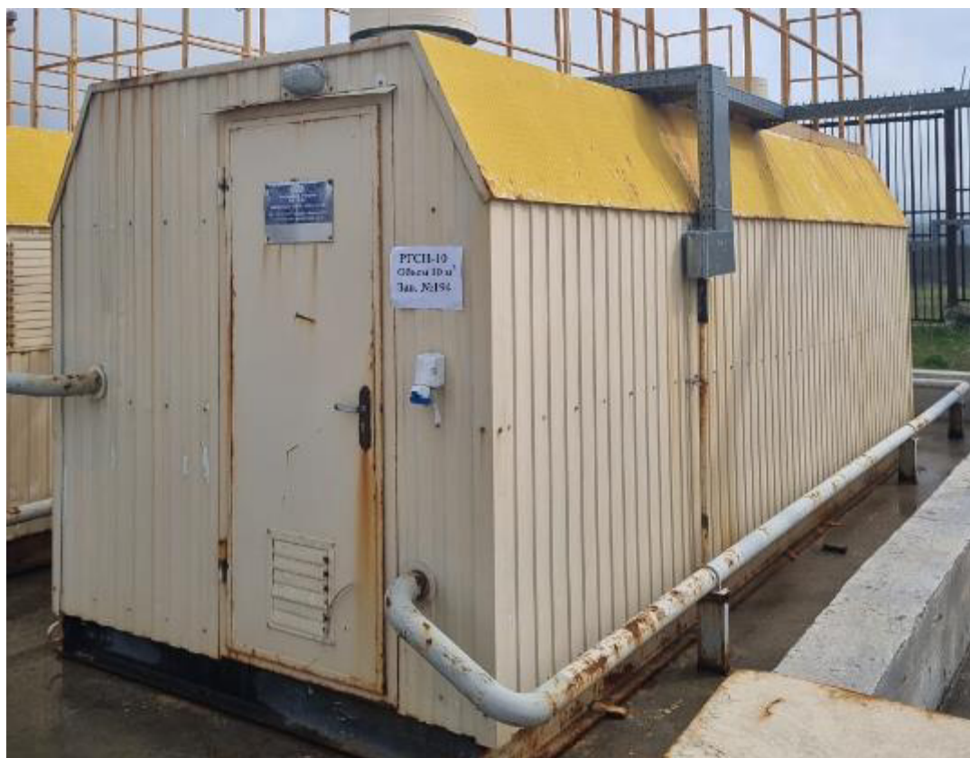
Рисунок 4 – Общий вид резервуара РГСН-10 зав.№ 194
