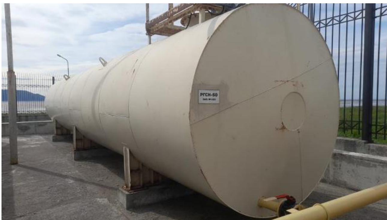
Рисунок 3 – Общий вид резервуара РГСН-50 зав.№ 233
