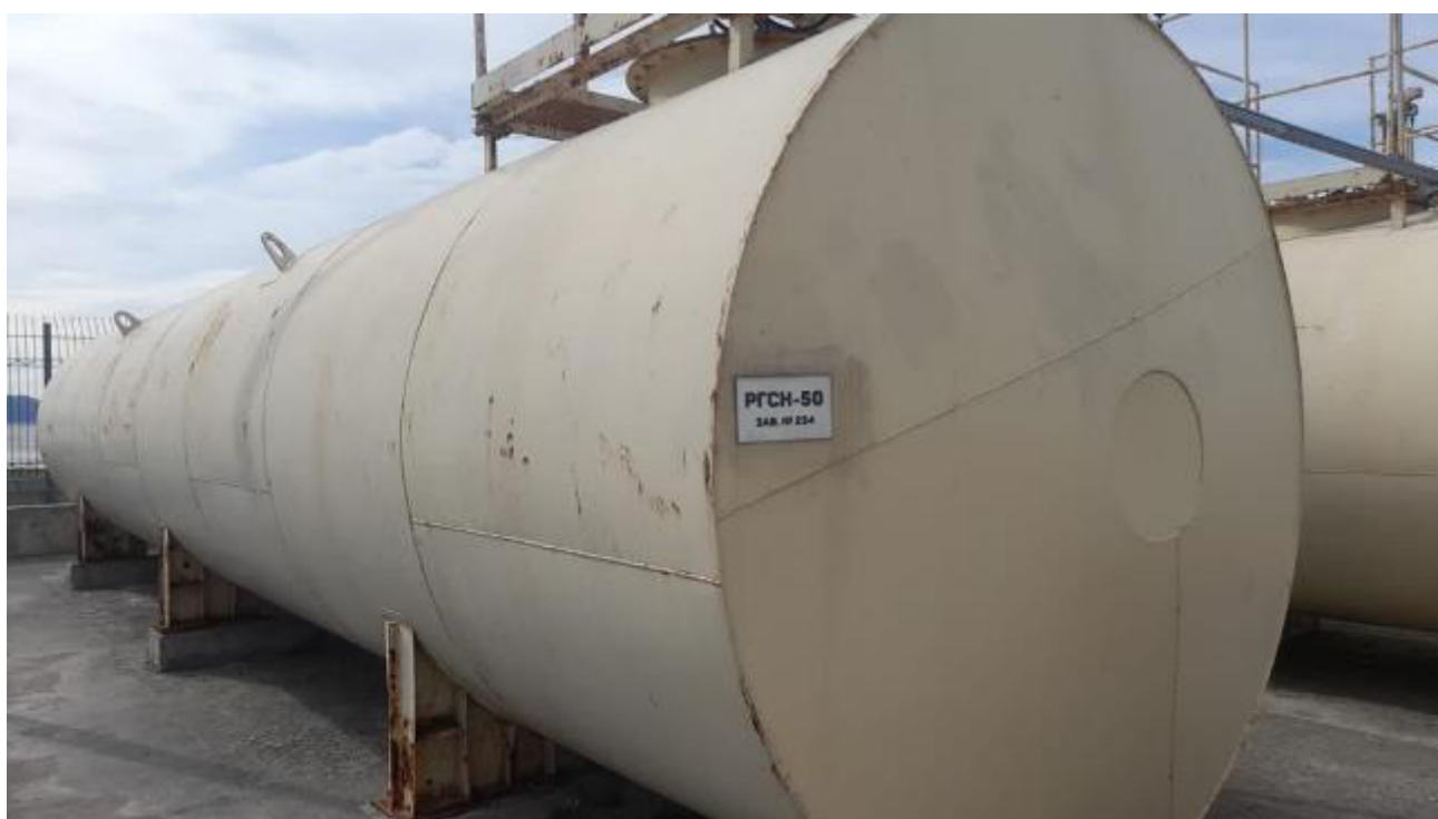
Рисунок 4 – Общий вид резервуара РГСН-50 зав.№ 234
