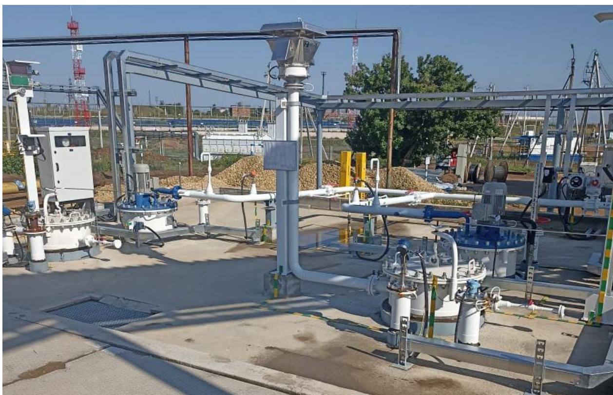
Рисунок 3 – Горловины и измерительные люки резервуаров ЕП-20-2400-2200-А-СО-У1
