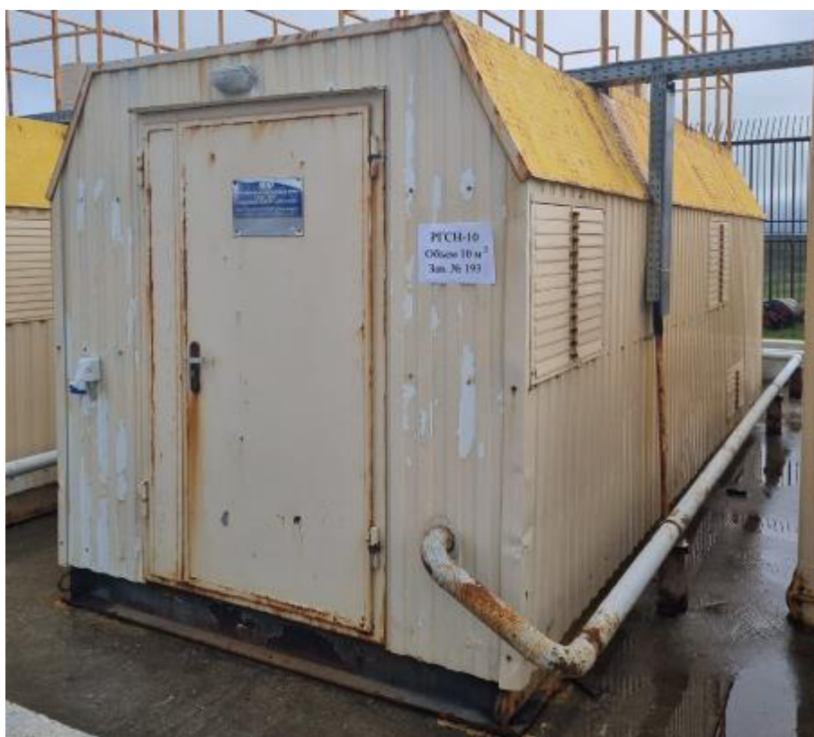
Рисунок 3 – Общий вид резервуара РГСН-10 зав.№ 193
