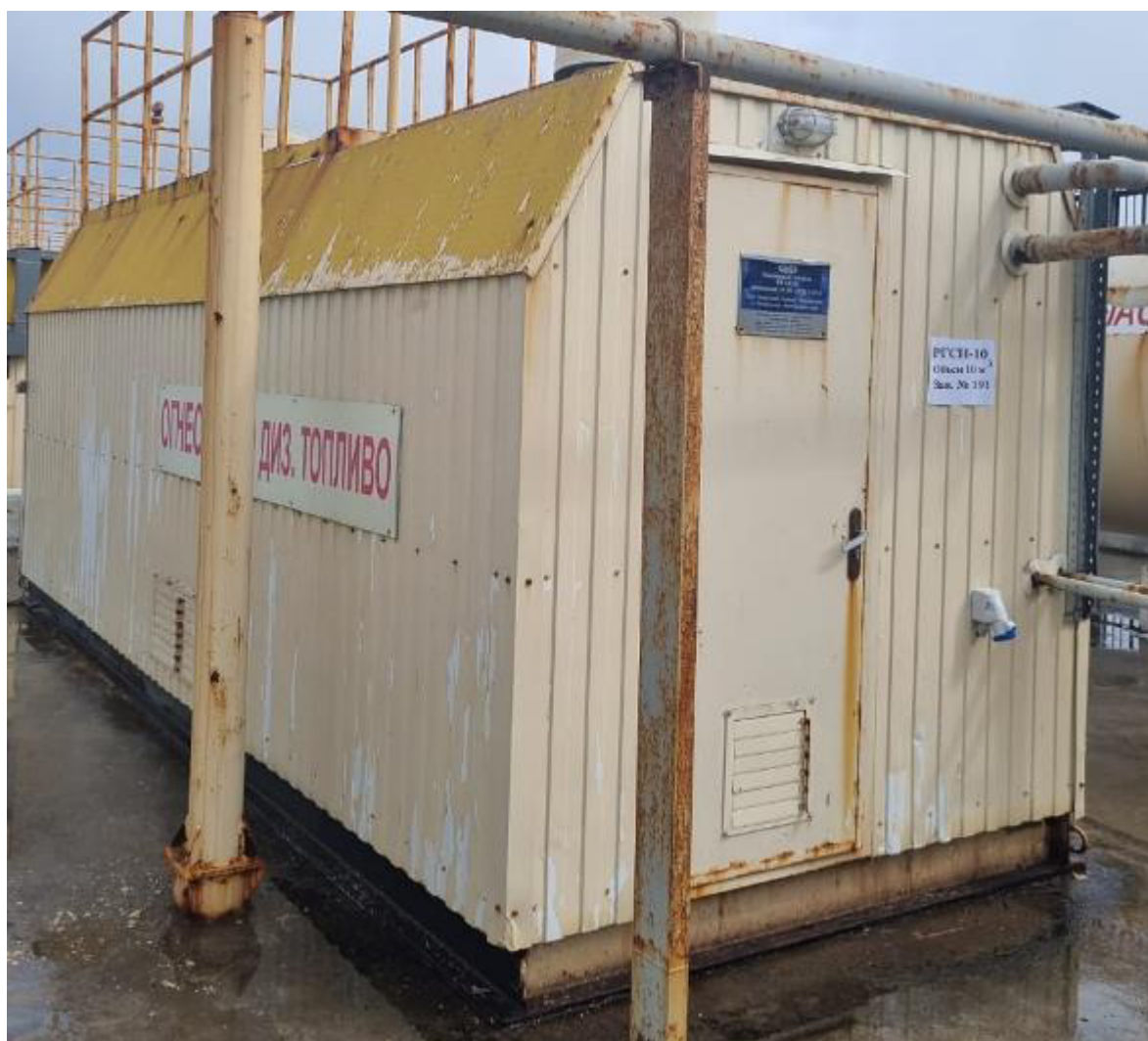
Рисунок 1 – Общий вид резервуара РГСН-10 зав.№ 191
