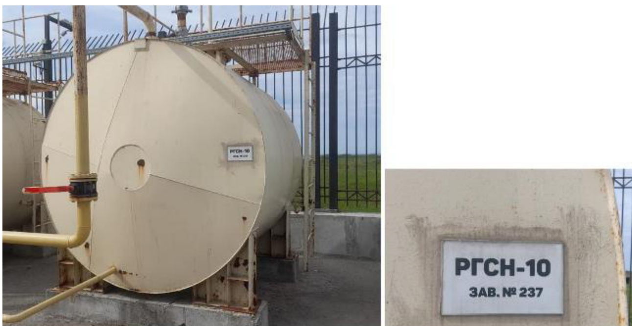
Рисунок 2 – Общий вид резервуара РГСН-10 зав.№ 237
