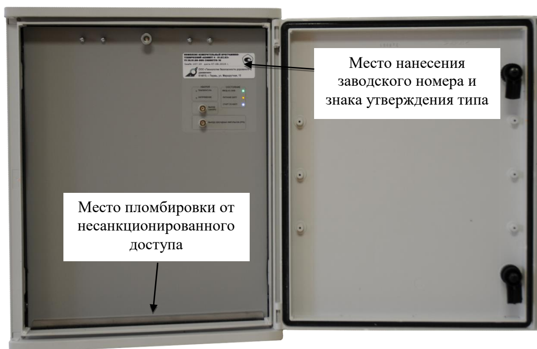
Рисунок 4 – Общий вид вычислительного модуля комплексов
