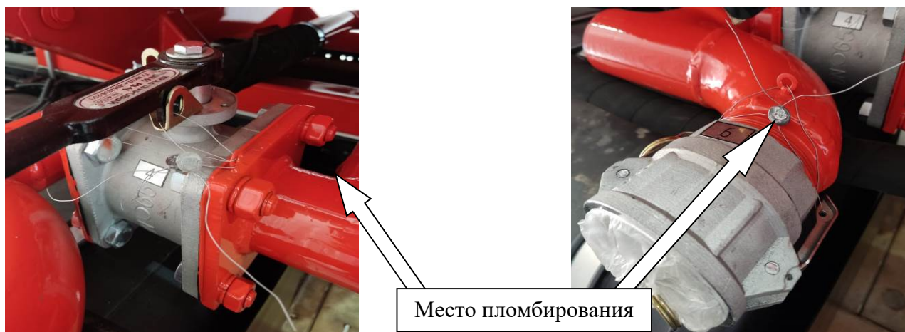
Рисунок 4 – Заглушка быстроразъемного соединения, кран шаровый на трубопроводе
