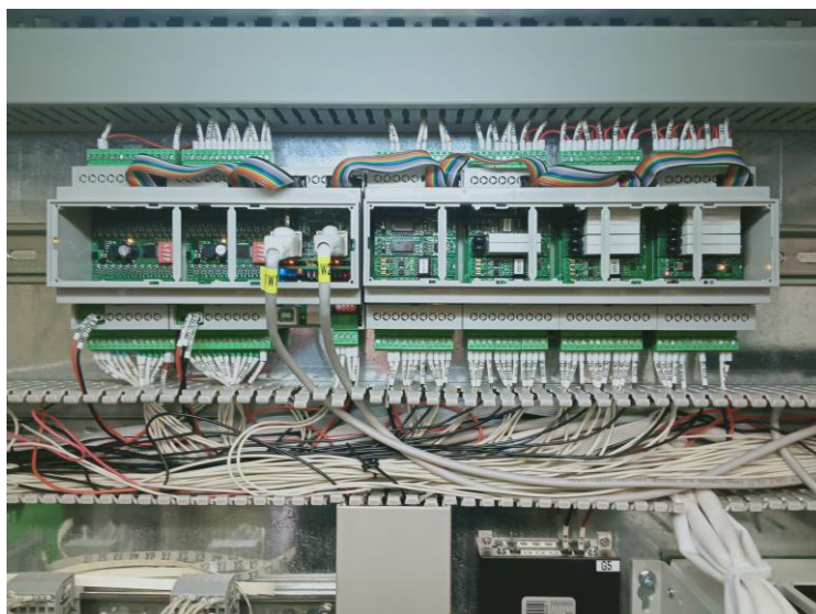
Рисунок 2 - Внешний вид контроллера в шкафу ПТК
