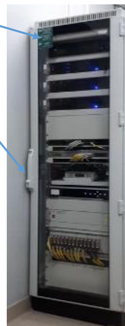
Рисунок 4 – Стойка приборная ИИС АПД-200. Вид общий
