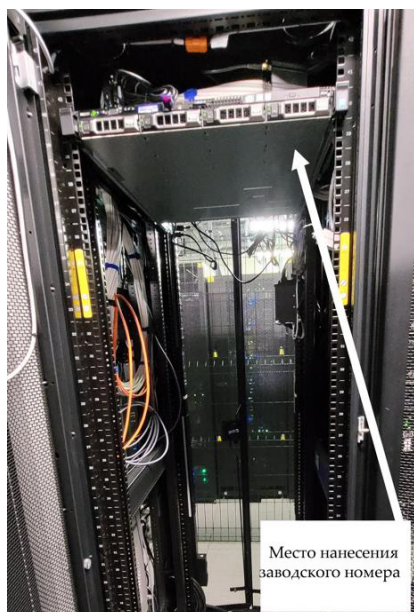
Рисунок 1 - Общий вид сервера ИВК ООО «МТС ЭНЕРГО» с указанием места нанесения заводского номера.
