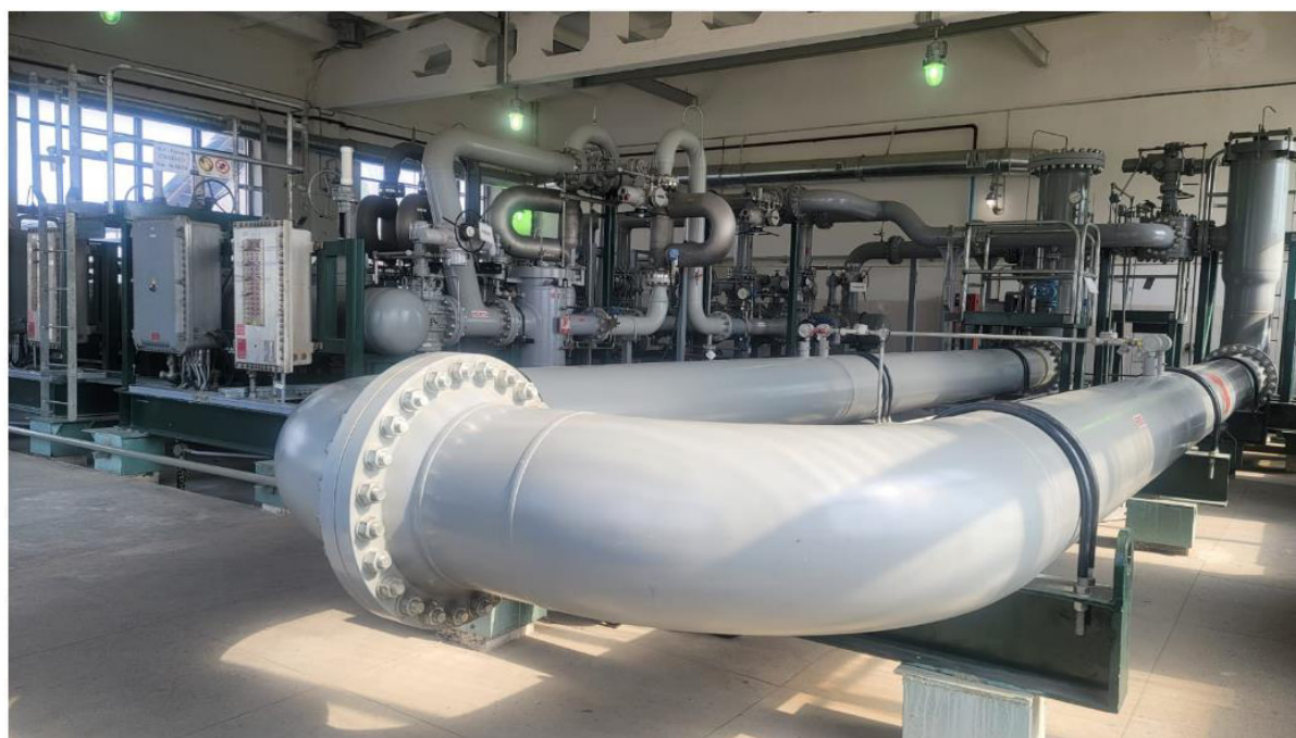
Рисунок 2 – Общий вид СИКН
