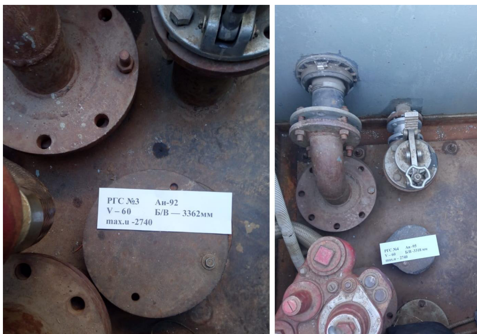
Рисунок 3 – Горловины резервуаров РГС-60 зав.№3, 4
