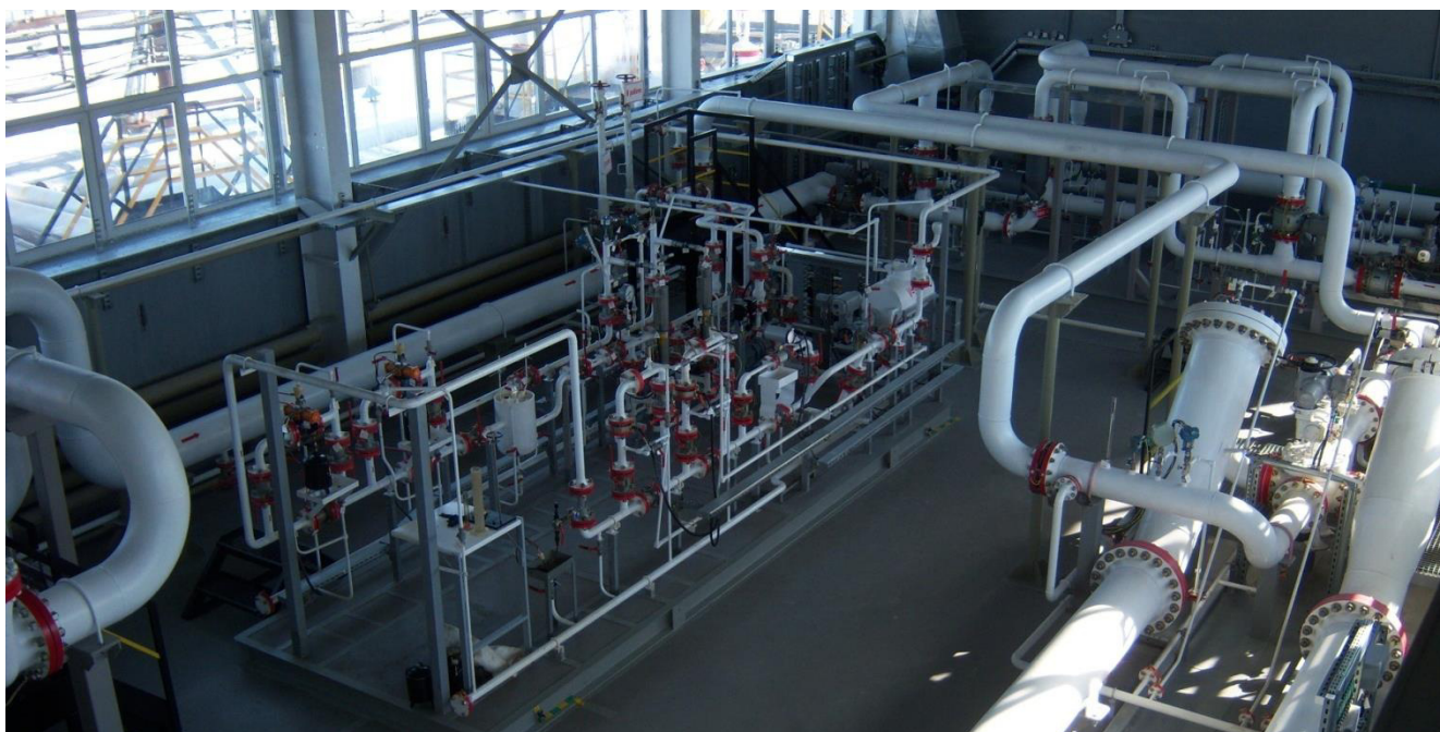
Рисунок 1 – Общий вид СИКН
