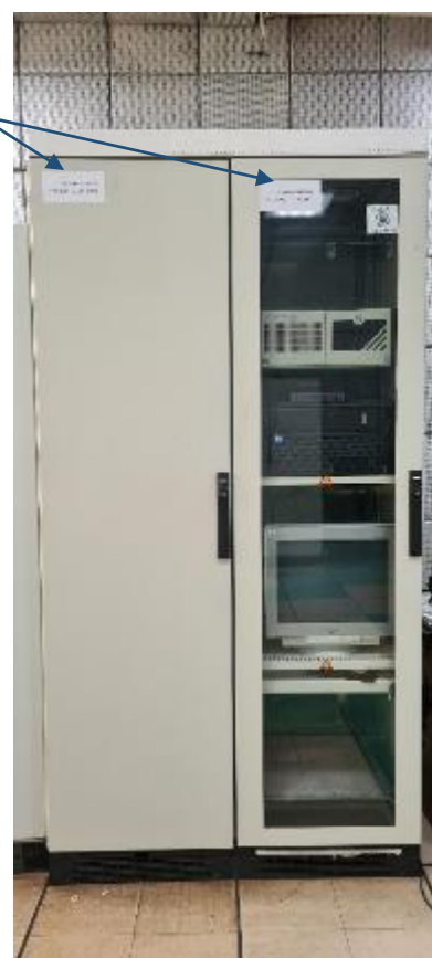
Рисунок 2 – Шкаф сервера. Вид внешний
