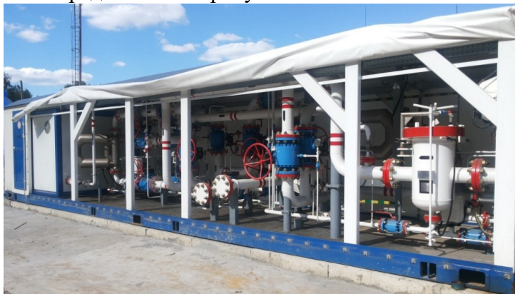
Рисунок 1 - Общий вид СИКН
