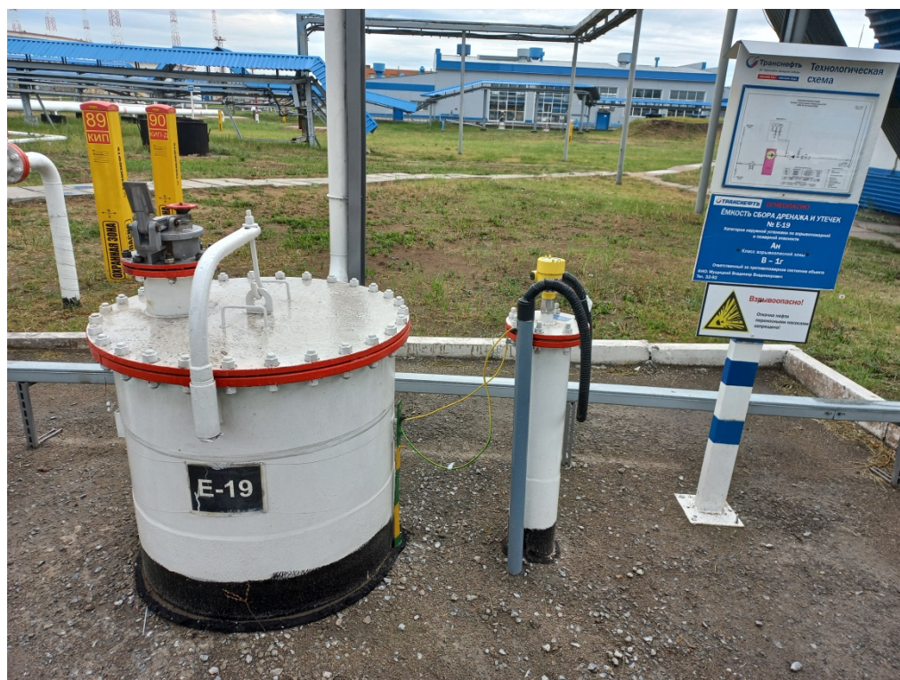
Рисунок 3 – Горловины и измерительный люк резервуара
