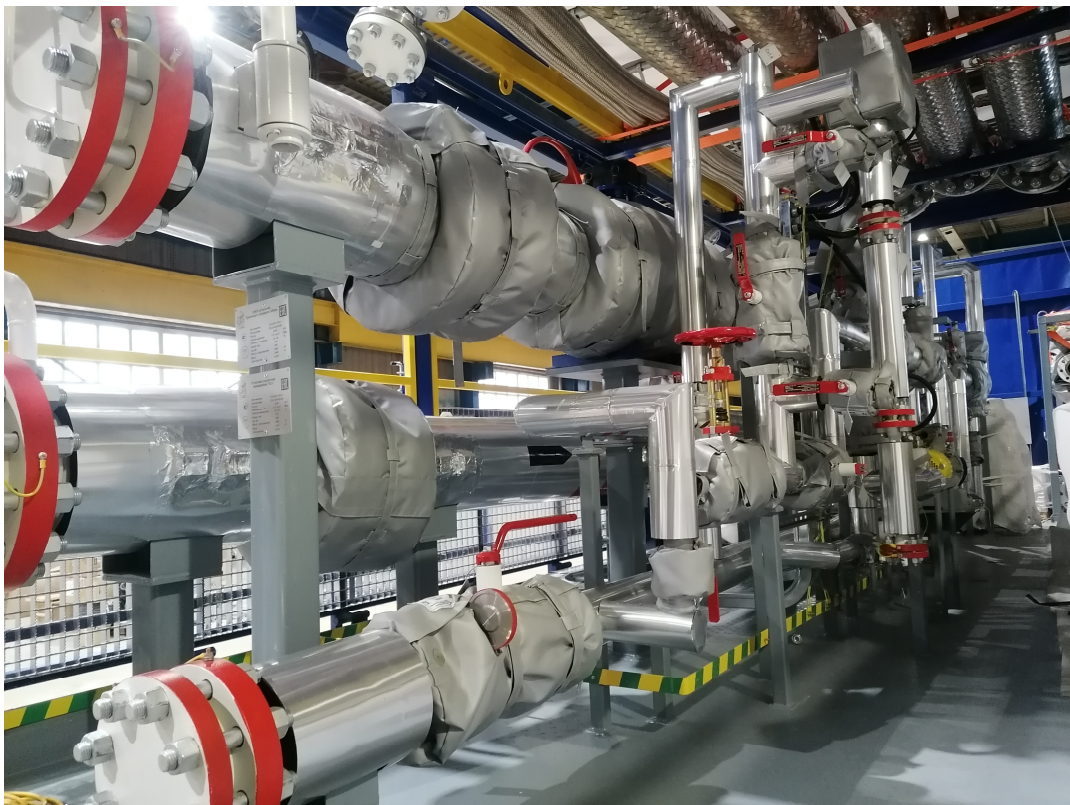
Рисунок 1 – Общий вид установки
