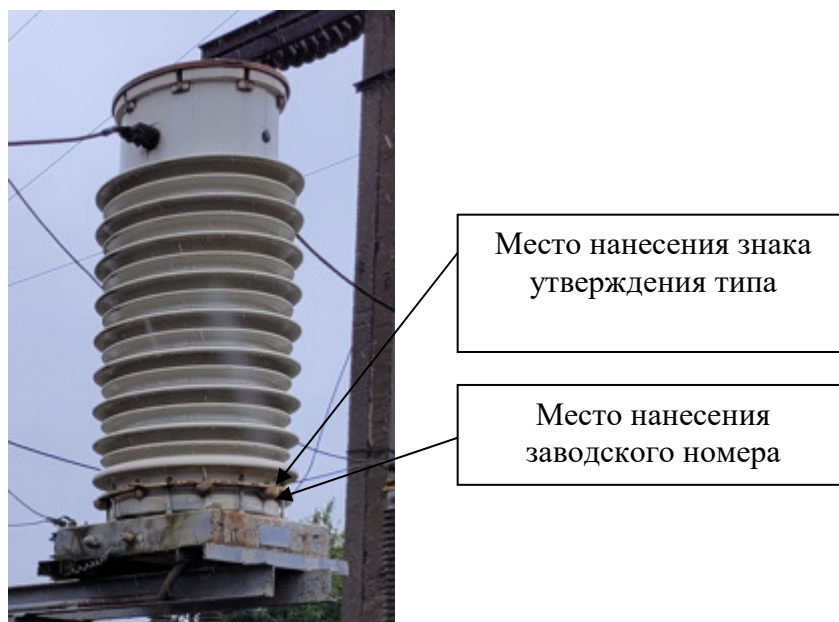
Рисунок 1 - Общий вид трансформаторов.
