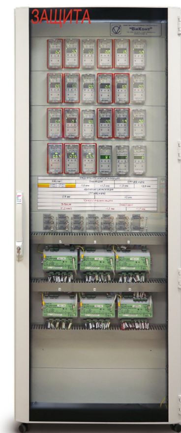
Рисунок 1 – Общий вид стойки управления
