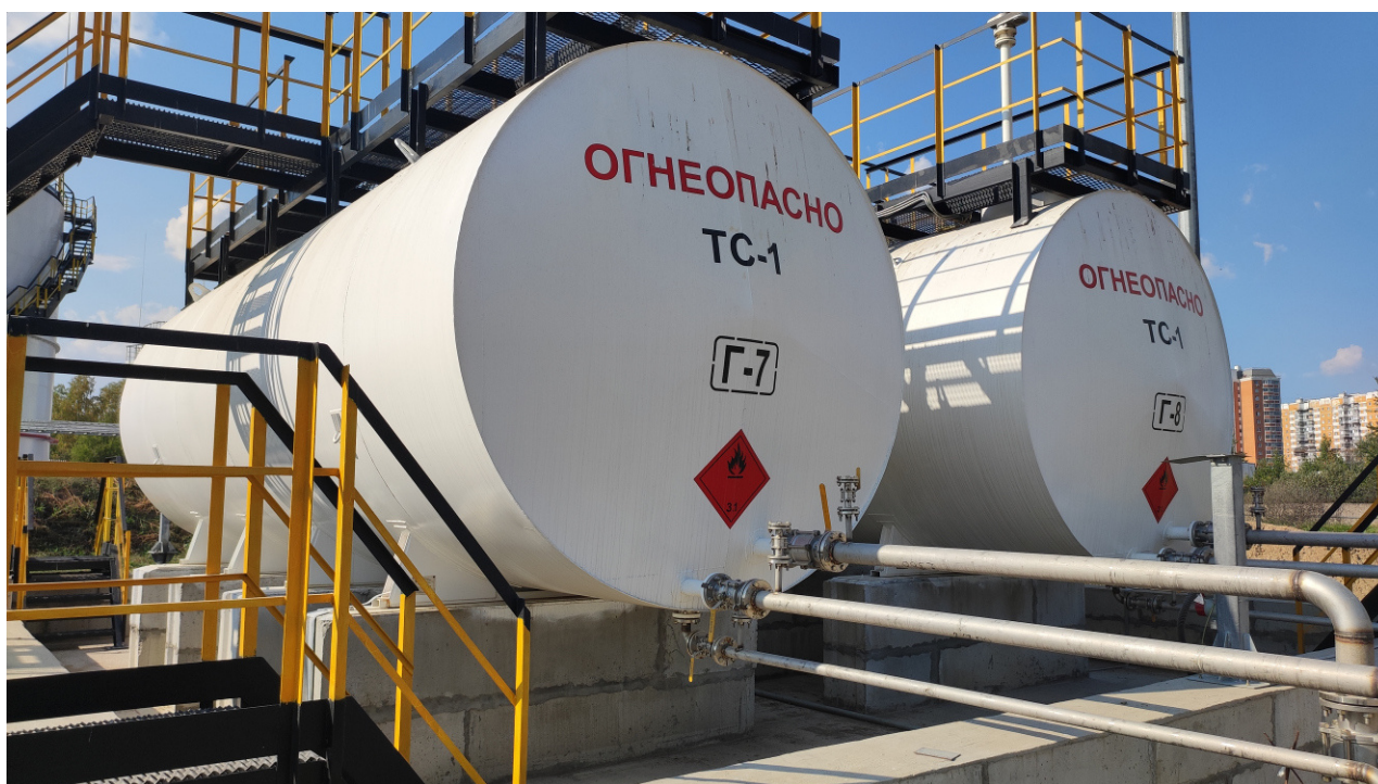
Рисунок 2 – Общий вид резервуаров РГ75
