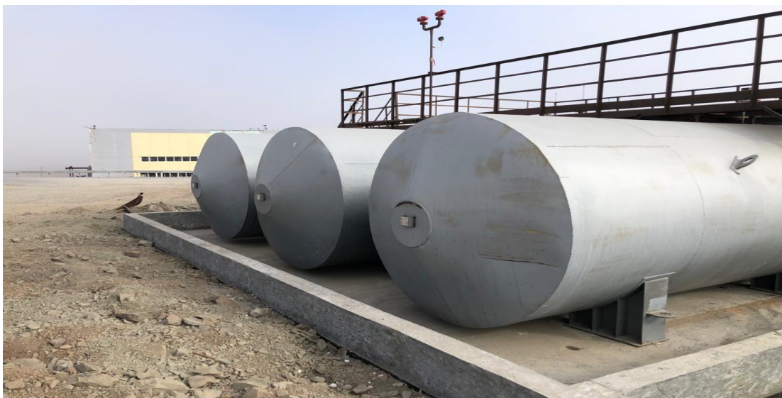
Рисунок 1 – Общий вид резервуаров РГСД-60 №000105, №000106, №000107
