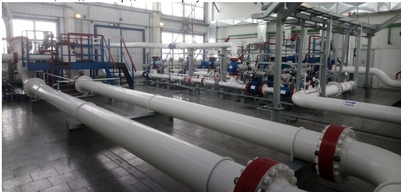
Рисунок 1 – Общий вид СИКН
