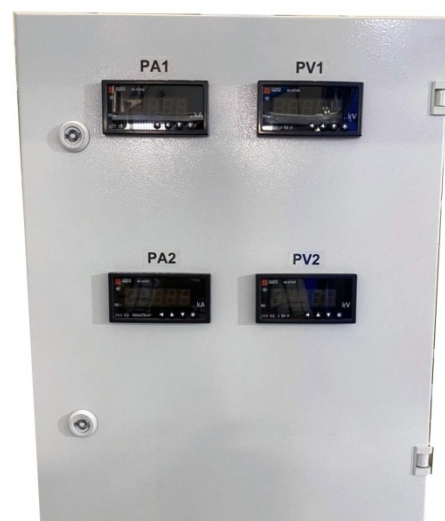
Рисунок 3 – Шкаф генератора постоянного тока
