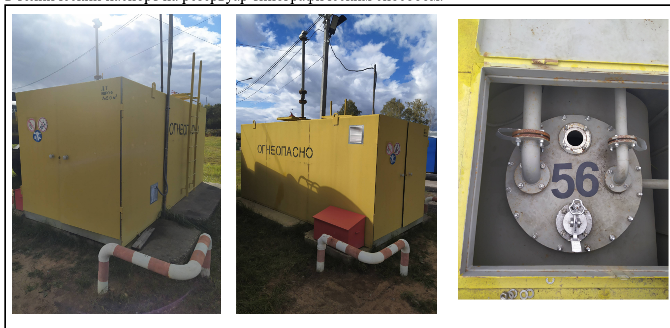
Рисунок 1 – Общий вид резервуара РГС-5 с замерным люком
