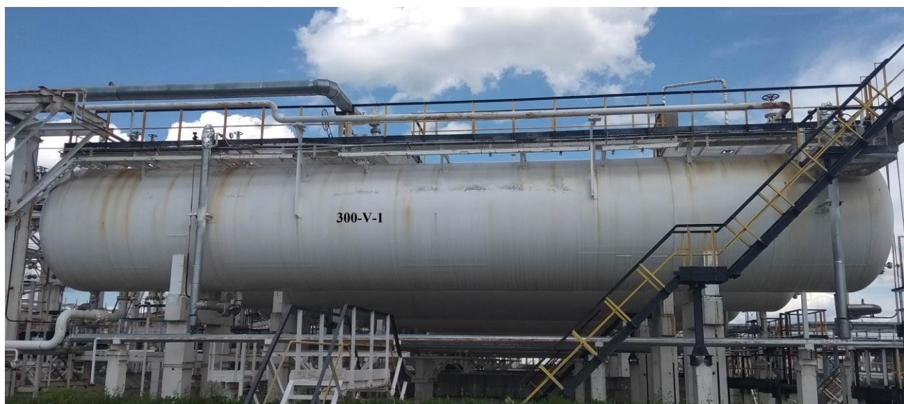
Рисунок 1 – Общий вид резервуаров РГС-200
