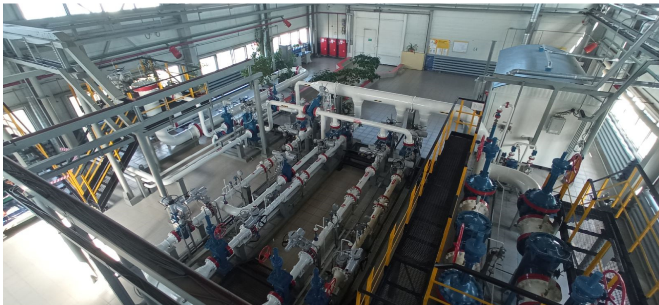
Рисунок 1 – Общий вид СИКН
