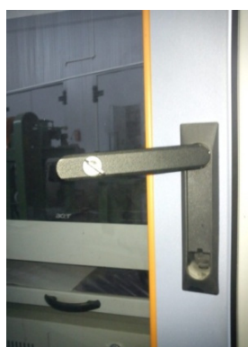
Рисунок 6 – Внешний вид замка на дверце стойки управления
