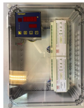
Рисунок 4 – Шкаф измерительный температуры
