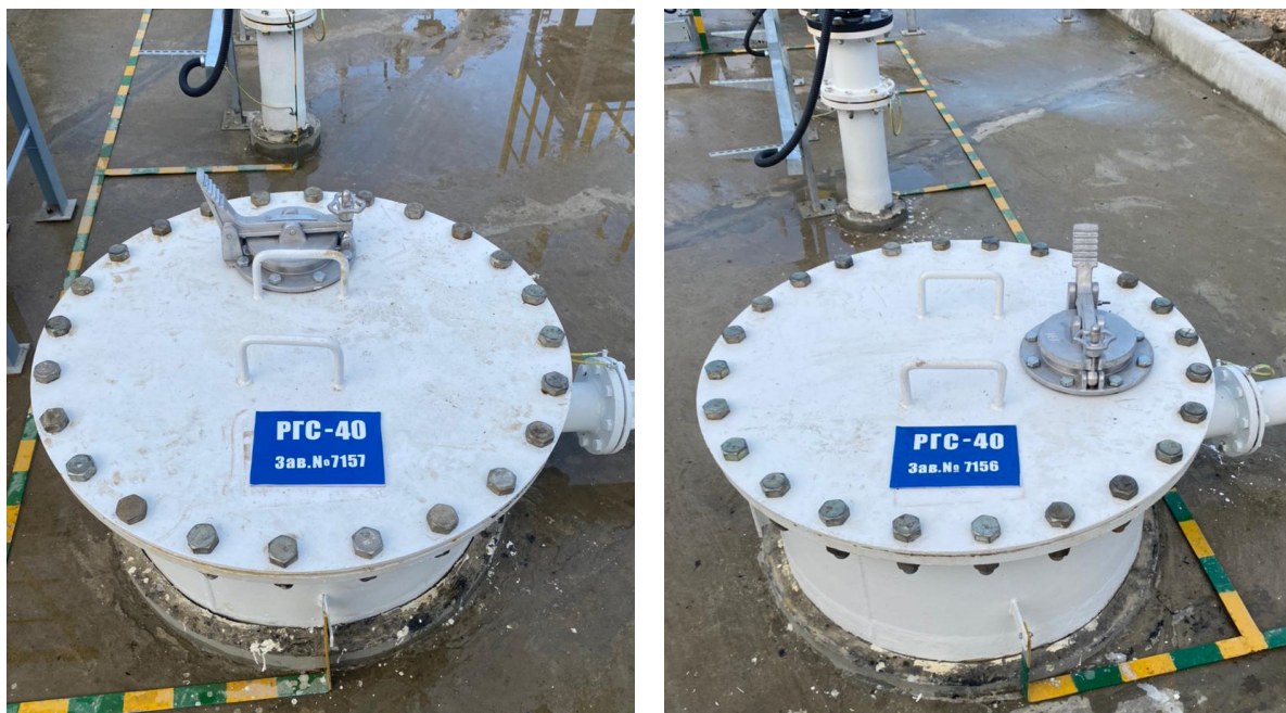
Рисунок 3 - Место нанесения заводских номеров резервуаров РГС-40
