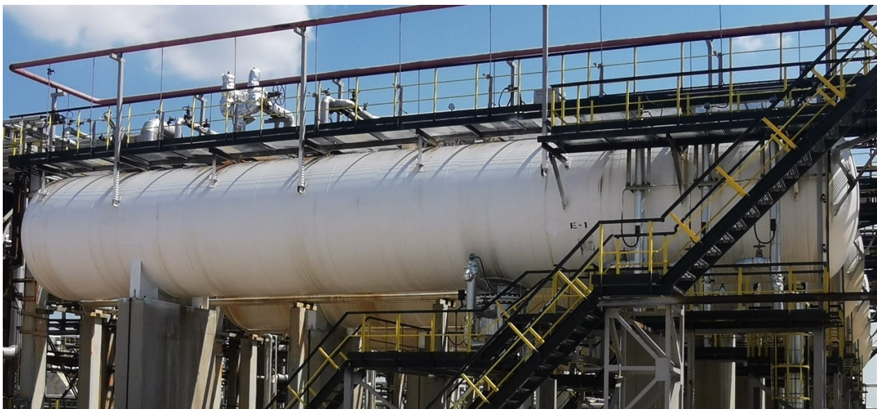
Рисунок 1 – Общий вид резервуаров РГС-200
