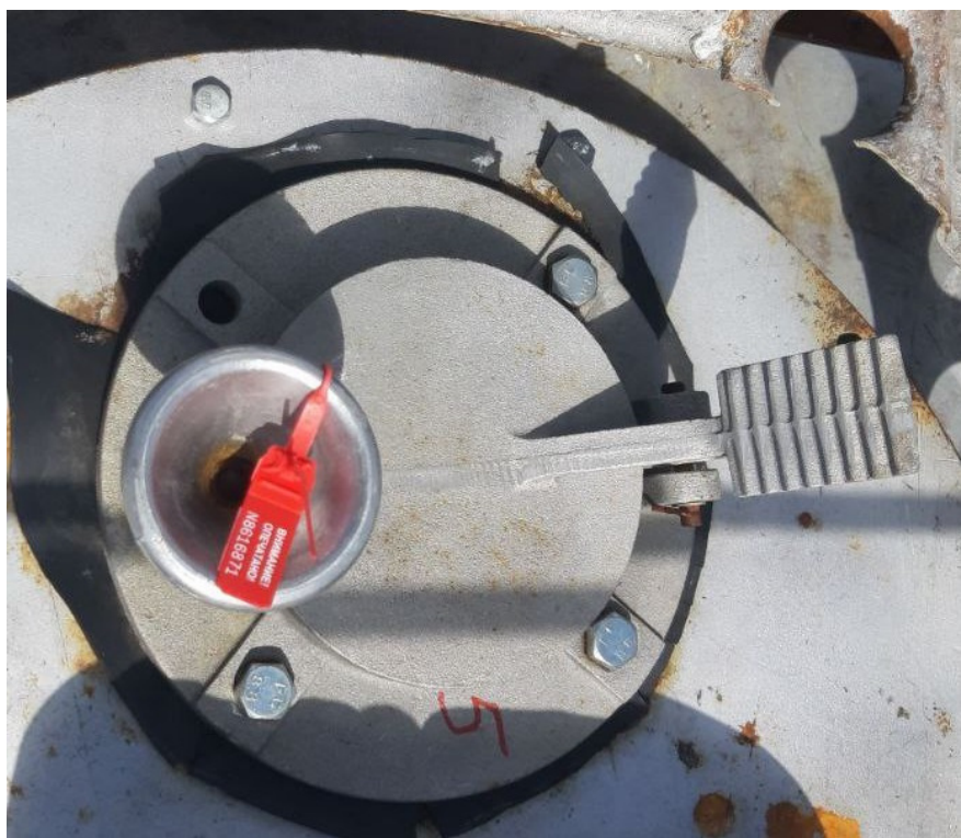
Рисунок 1 – Общий вид резервуаров РГС-60 №5
