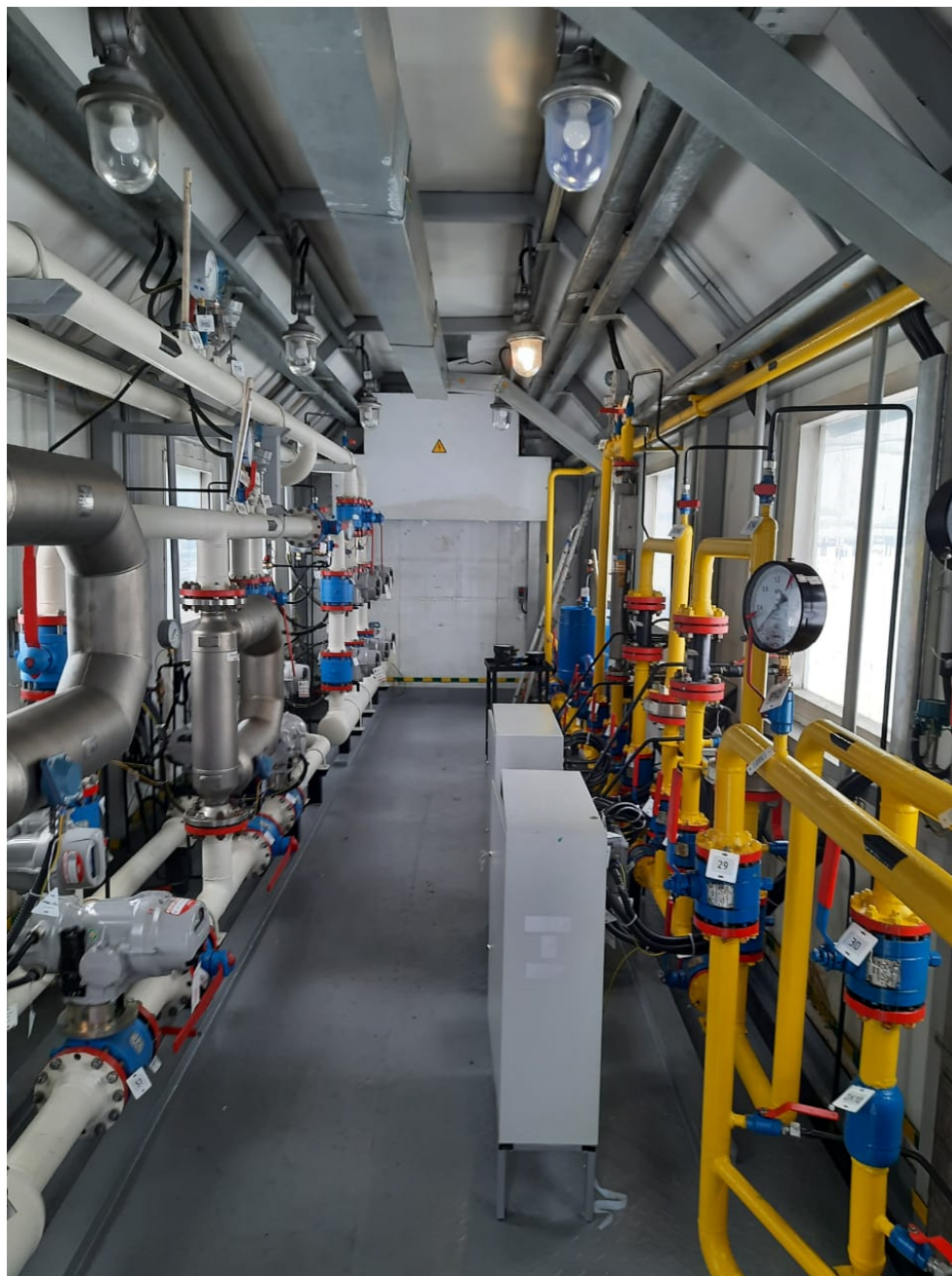
Рисунок 1 – Общий вид СИКН
