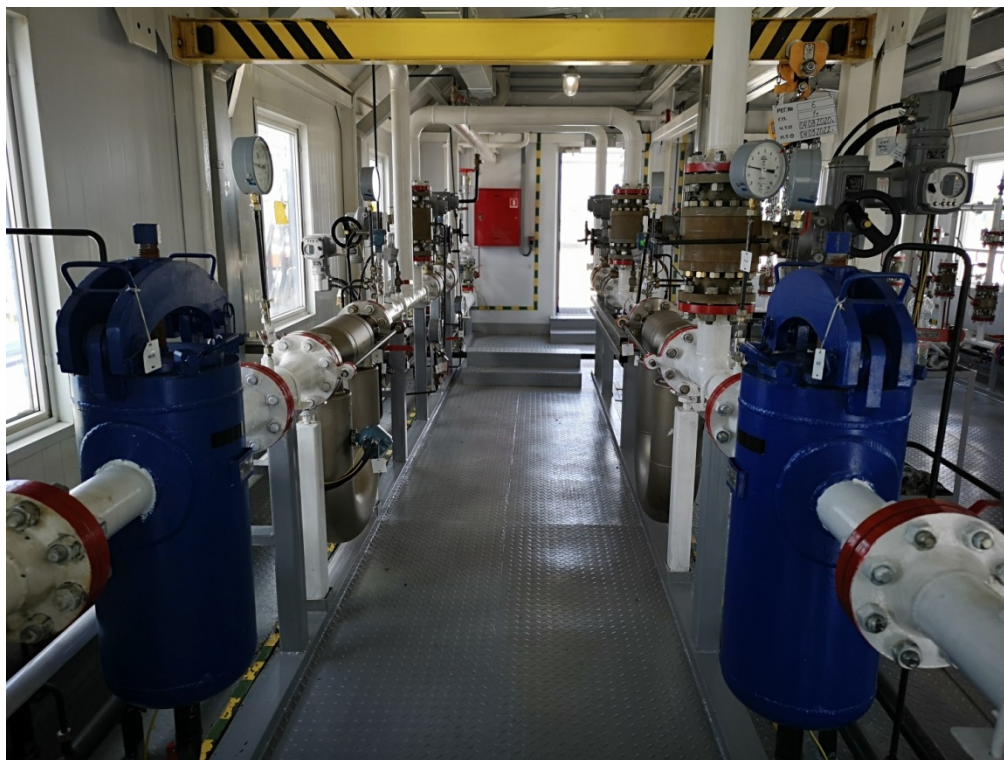
Рисунок 1 – Общий вид СИКН
