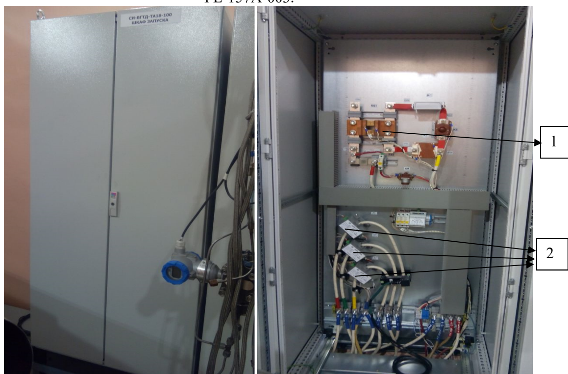
Рисунок 6 – Шкаф запуска (ШЗ)
