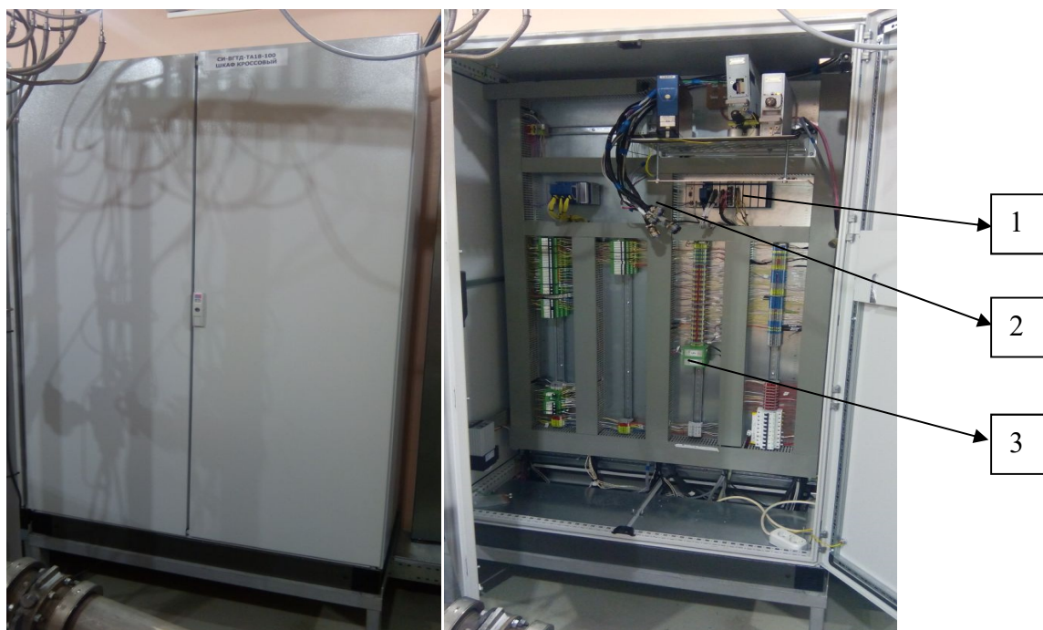
Рисунок 5 – Шкаф кроссовый (ШК)
