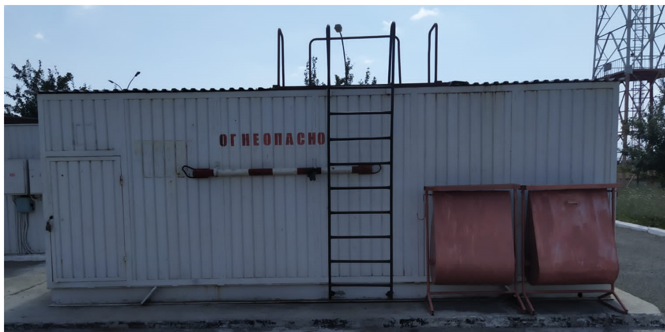
Рисунок 1 – Место расположения резервуаров РГС-5 с заводскими номерами 69/1, 69/2
