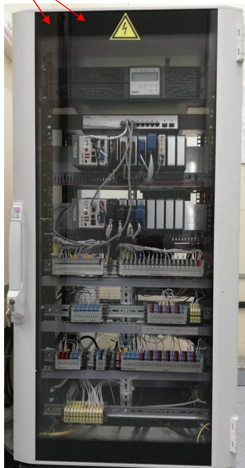
Рисунок 1 – Общий вид электромонтажного шкафа
