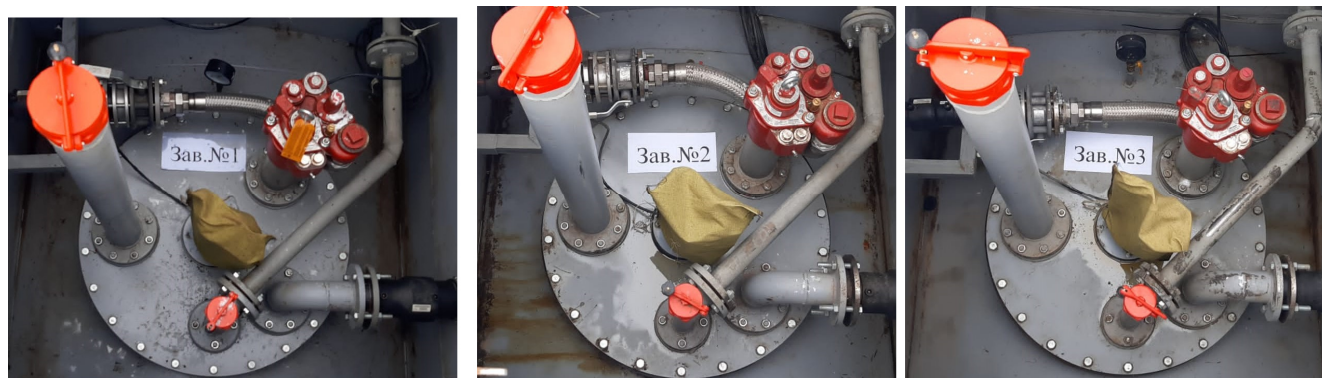
Рисунок 1 – Общий вид резервуаров РГС-25
