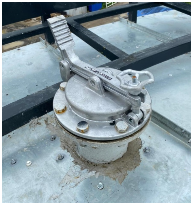
Рисунок 3 – Фото замерного люка резервуаров РВС-700
