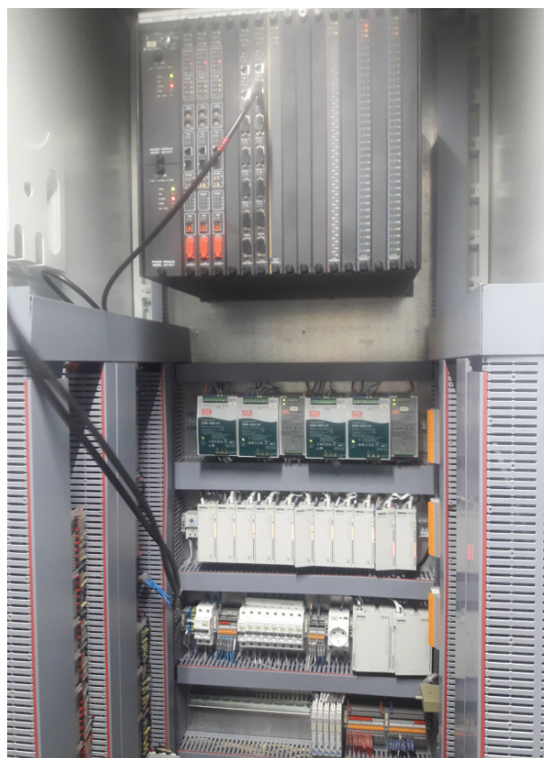
Рисунок 1 - Общий вид электротехнического шкафа комплекса
