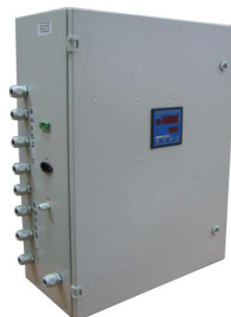
Рисунок 3 – Шкаф генератора переменного тока
