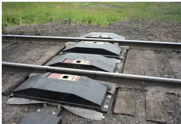
Рисунок 1 – Напольное оборудование Комплекса-2С
