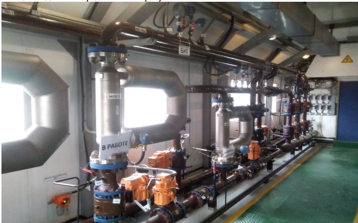
Рисунок 1 – Общий вид СИКН
