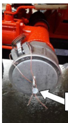
Рисунок 2 – Пломбировка трубопровода слива-налива
