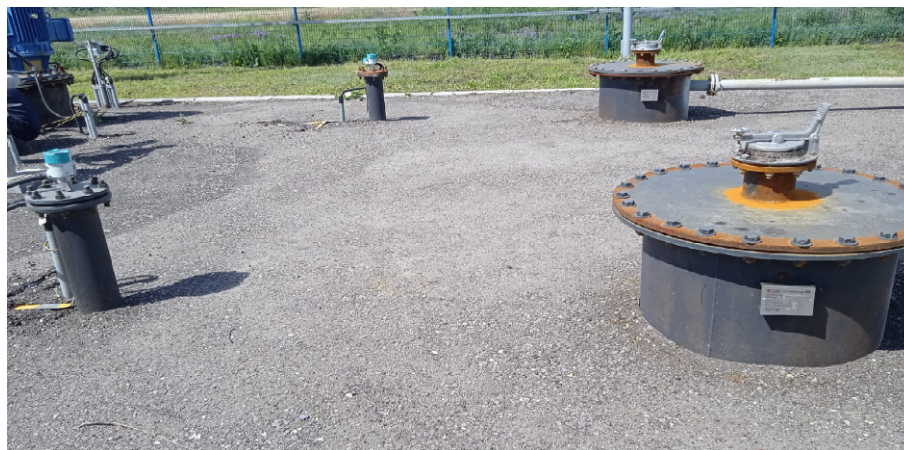
Рисунок 4 – Общий вид резервуара горизонтального стального РГСП-100 заводской номер 14
