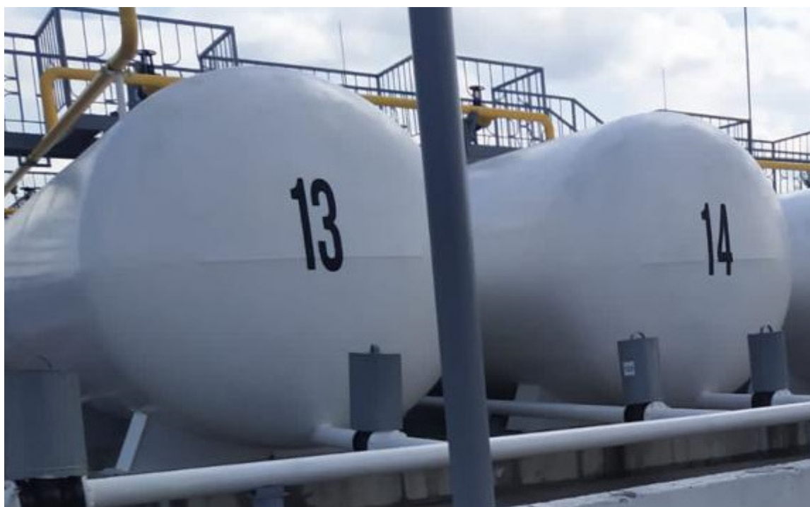
Рисунок 1 – Общий вид резервуаров РГС-75
