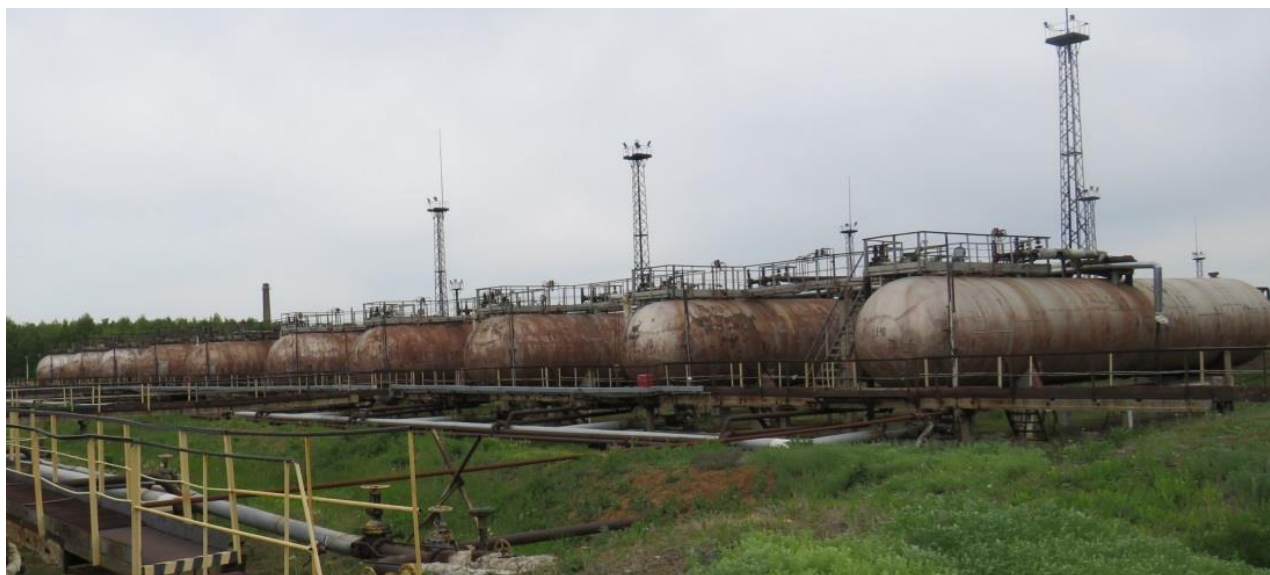
Рисунок 1 – Общий вид резервуаров РГС-200
