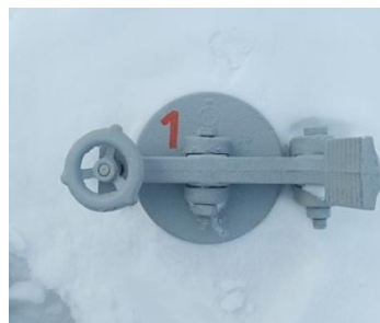
Рисунок 3 – Общий вид замерного люка резервуара
