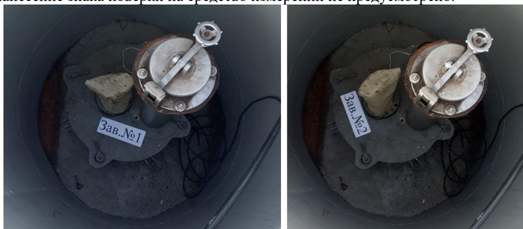
Рисунок 1 – Общий вид резервуаров РГС-60
