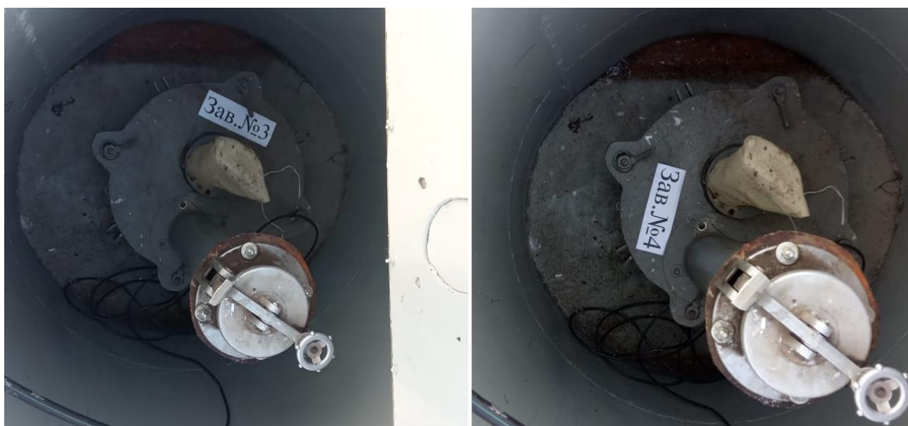
Рисунок 2 – Общий вид резервуаров РГС-60
