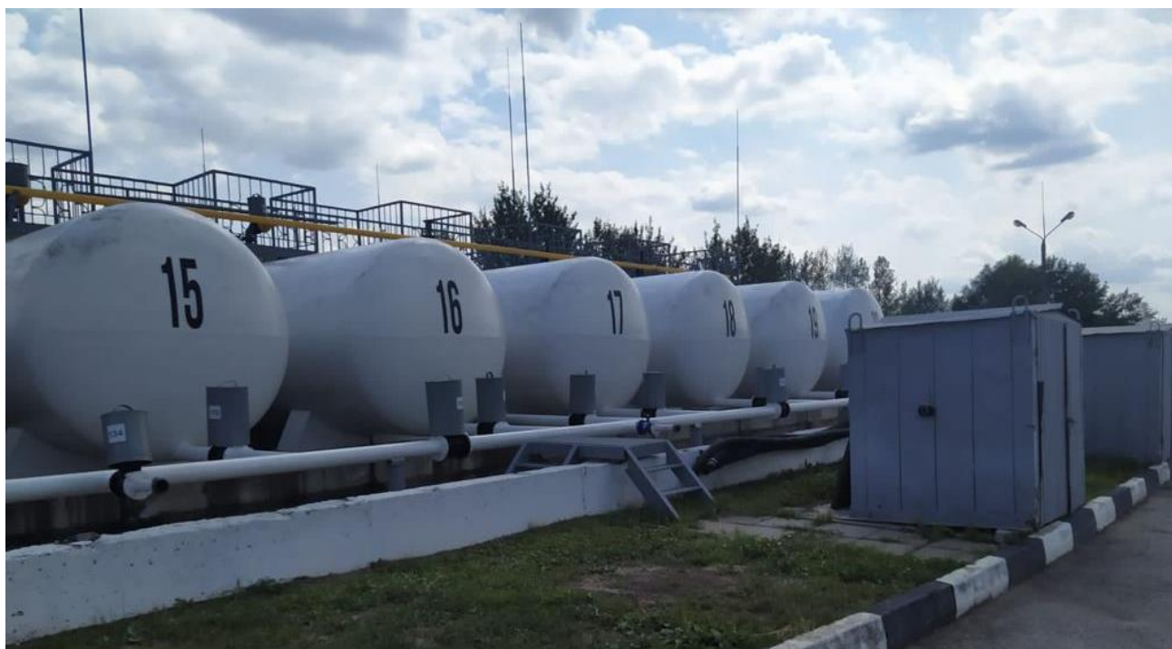
Рисунок 1 – Общий вид резервуаров РГС-50
