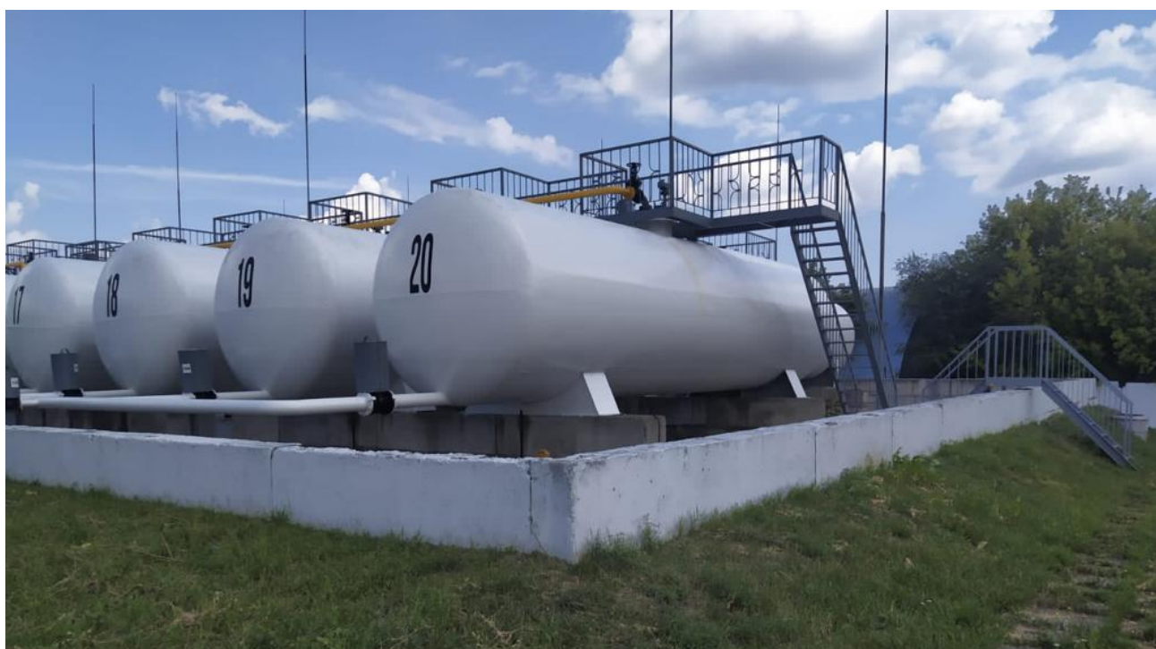
Рисунок 2 – Общий вид резервуаров РГС-50
