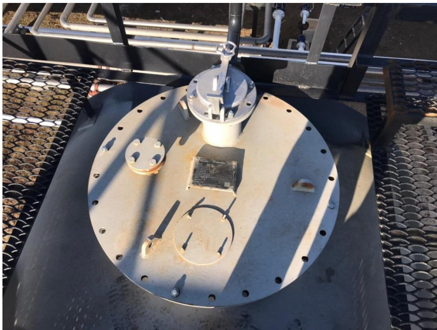
Рисунок 8 – Горловины и замерной люк резервуара РГСН-50, зав. №234/2.
