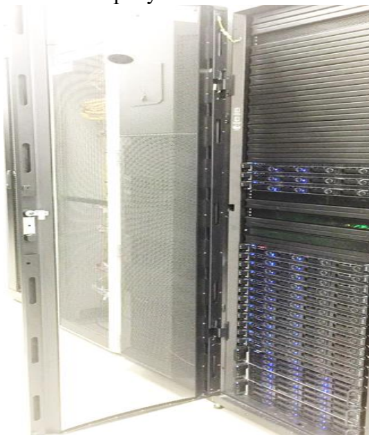
Рисунок 1 – Внешний вид шкафа
