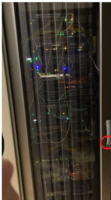
Рисунок 3 – Место блокировки от несанкционированного доступа к стойке с оборудованием
