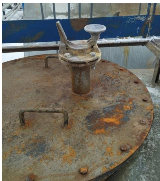
Рисунок 4 – Фото замерного люка резервуаров РГСН-100
