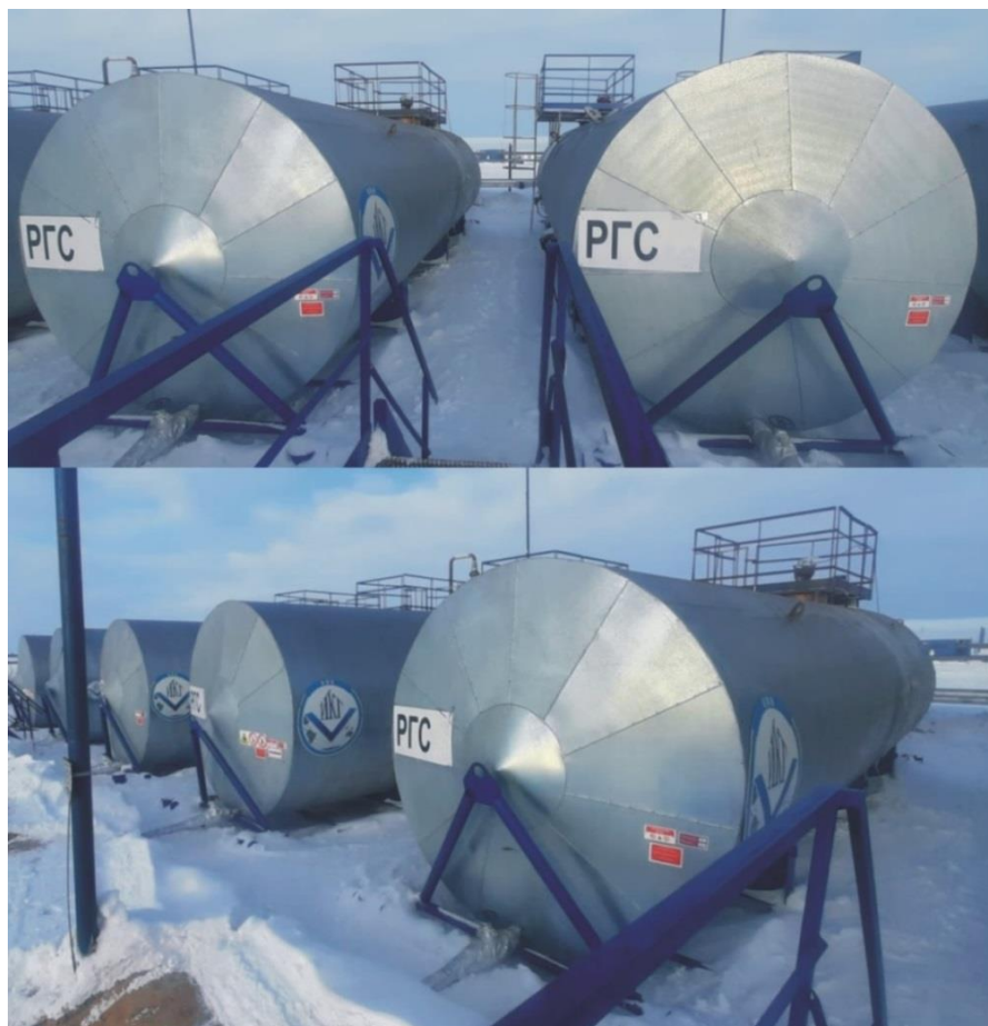
Рисунок 1 – Общий вид резервуаров РГСН-100
