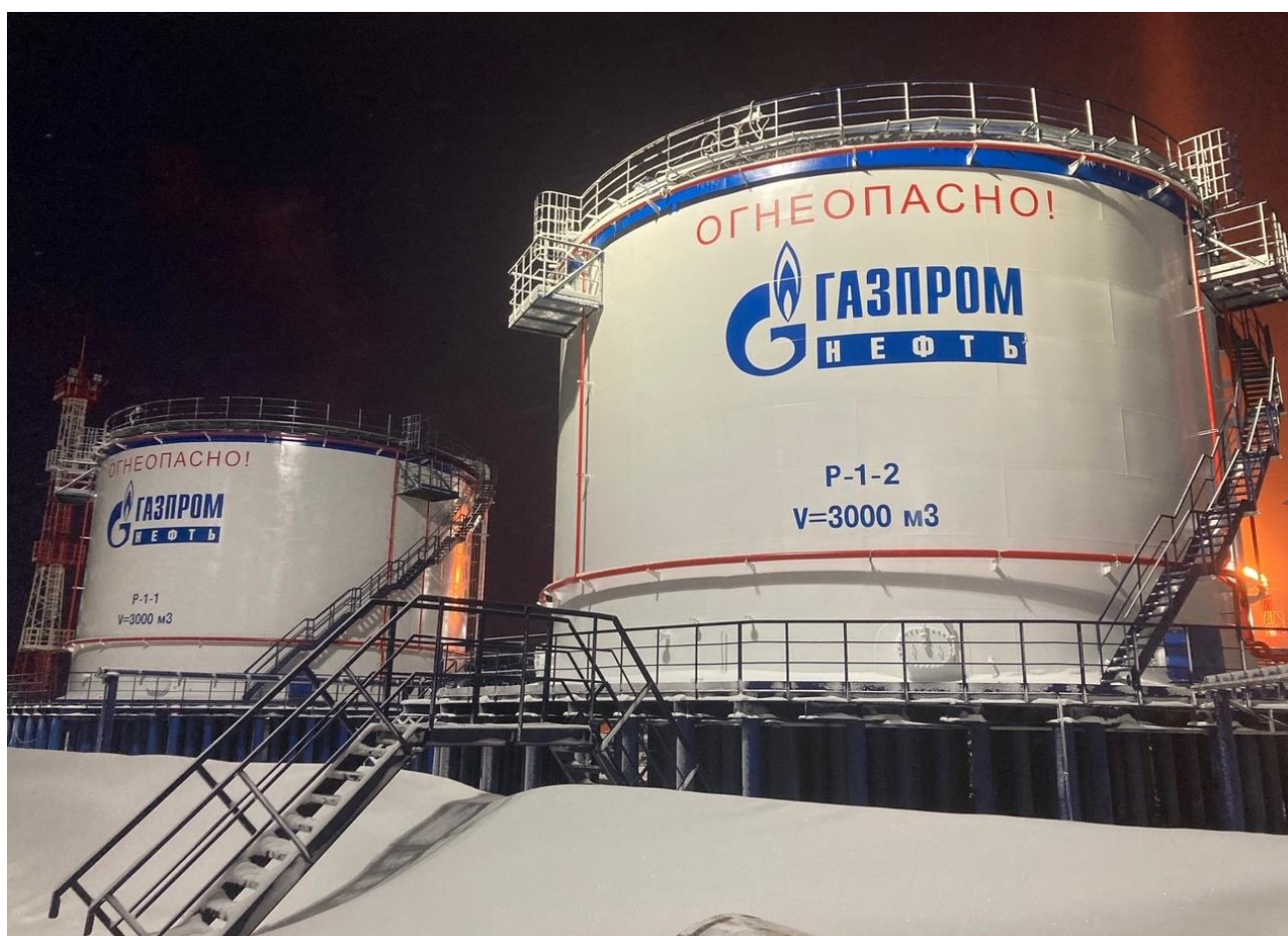
Рисунок 2 – Общий вид резервуаров PBC-3000
